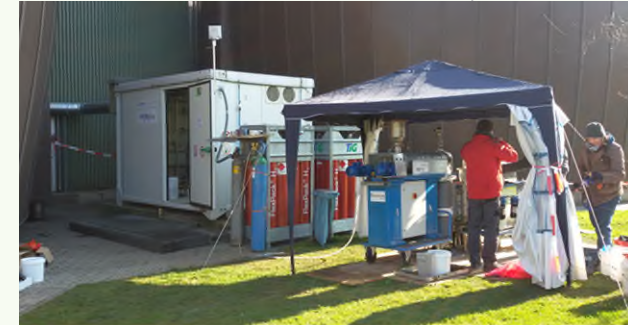
Kopplung des TCR Reaktors von Fraunhofer Umsicht mit der Technikumsanlage der MicroPyros GmbH; Kläranlage Straubing, 2017
